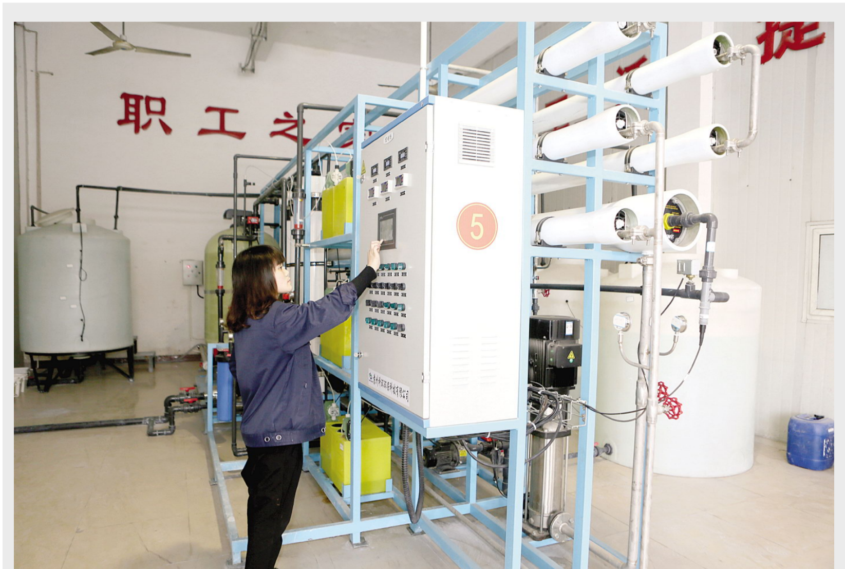
近年来,飞洋钛白粉制造有限责任公司加大企业环保投入,引进废水处理设备,对生产过程中形成的工业废水进行净化处理循环利用,实现工业废水零排放。李峰 李宜瑄 摄
