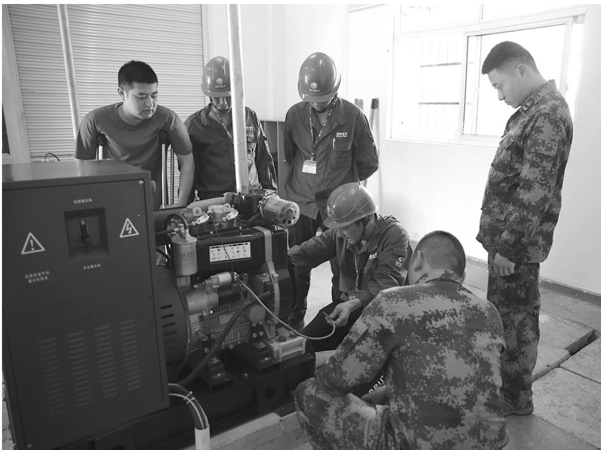
现场处理机房发电机缺陥
