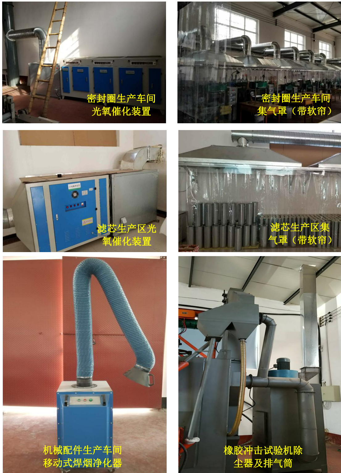
图 3-1 废气处理装置设备现场照片
