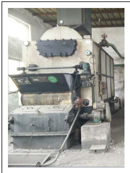
燃煤锅炉现状
