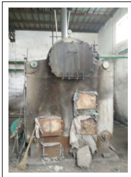
燃煤锅炉现状
