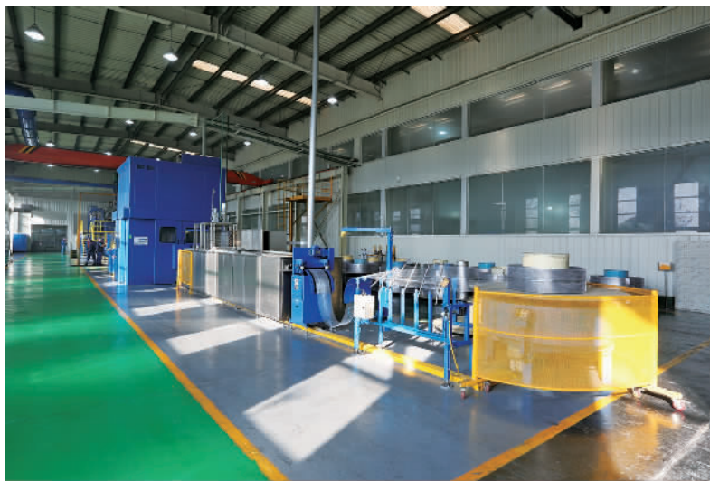
风帆自动化蓄电池生产线
