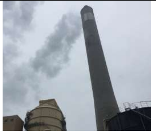
图 4-6 湿式静电除尘器
