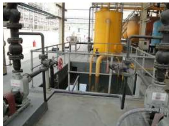
图 4-15 氨事故废水收集池
