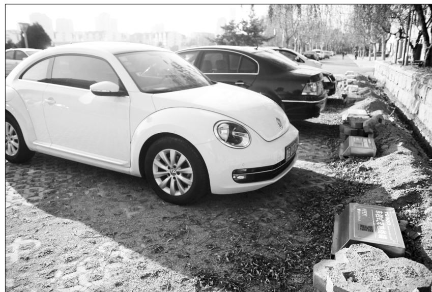
青岛大学体育馆停车场近日安装了电动汽车充电终端,青岛大学成为山东省首家安装汽车充电设施的高校。在大学里安装电动汽车充电设施,意在倡导节能环保,鼓励在校师生使用新能源汽车。
