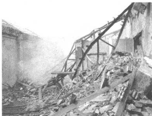
图 7 火灾后倒塌的钢屋架
