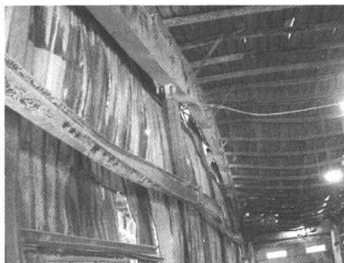
图 6 火灾后的钢结构工业厂房
