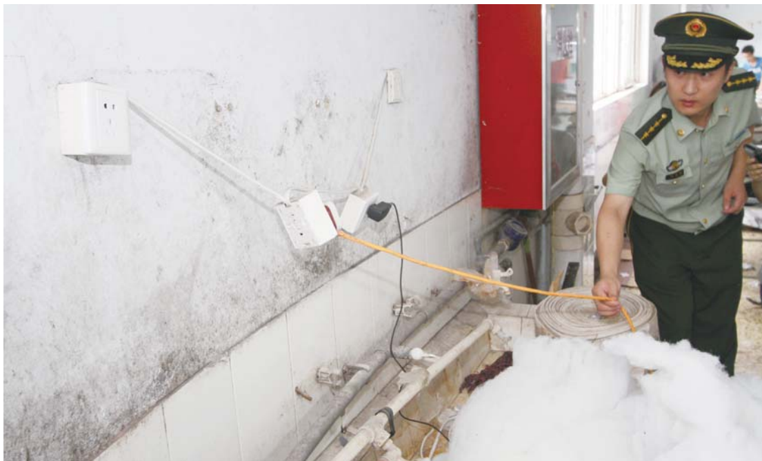
4日,经济技术开发区一家制衣厂内,混乱的电线插座附近堆放着易燃的化纤棉。 本报记者 王小会 摄
