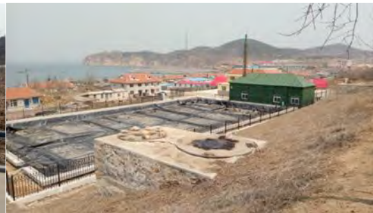
渗滤液处理系统
