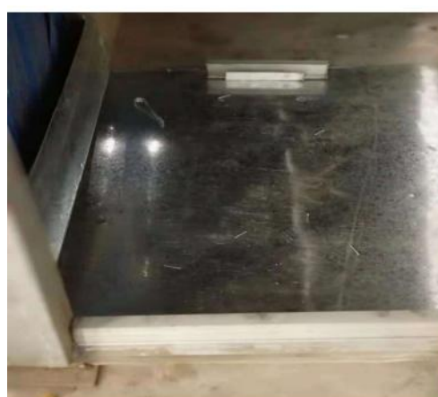
危废间防渗及围堰
