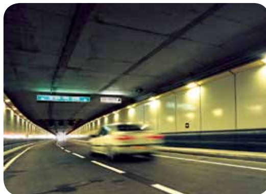
隧道内的空气净化和排烟系统
