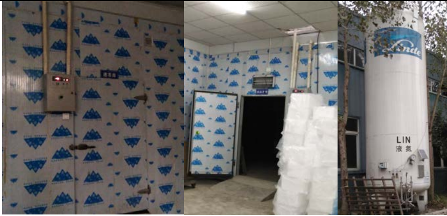
图 5-6 速冻库、成品冻库与液氮装置
