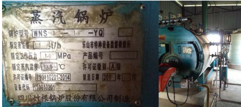
图 1-2 依托宁斐公司蒸汽锅炉
