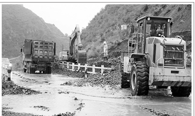
近日,天水市持续出现强降雨天气,造成天水公路管理局管辖的部分公路路基掏空、路面断裂。天水公路管理局立即启动公路突发事件应急预案,组织抢险突击队第一时间赶赴抢险现场,抢修水毁路段。岳玲摄
