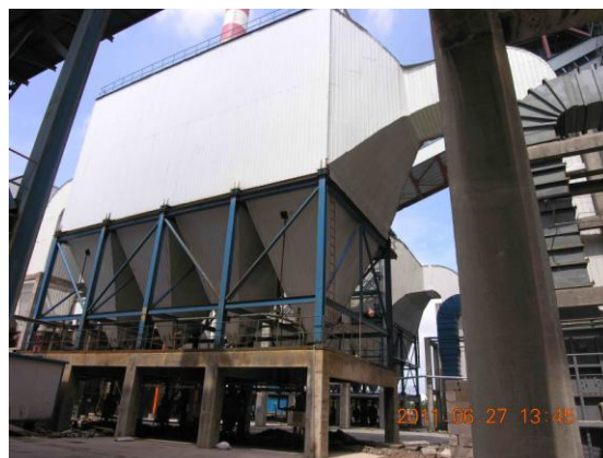
四电场静电除尘
