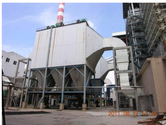
三电场静电除尘
