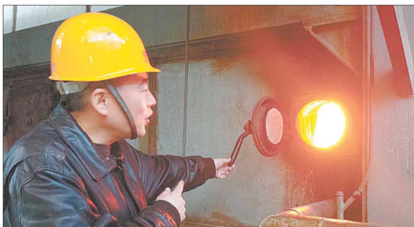
供暖季到了,领秀城热源厂供热车间里炉火熊熊燃烧。
