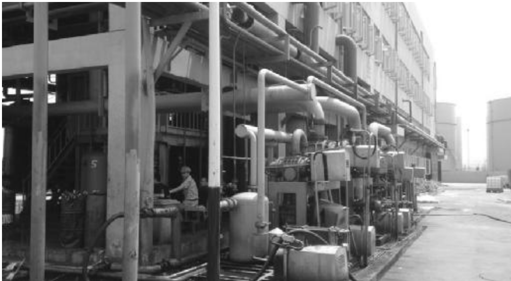
温州 10 万吨生物柴油示范工程
