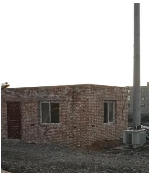
项目区配电室
