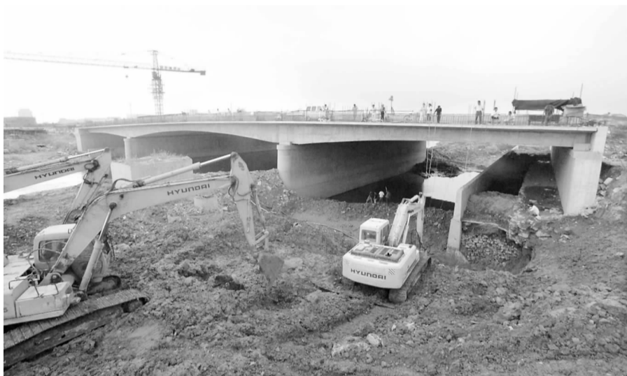
正在紧张施工中的小清河板桥工程日前进展顺利,记者在现场看到,新板桥的基础工程已经成型,目前可允许少量行人及小型车辆限时通过。
