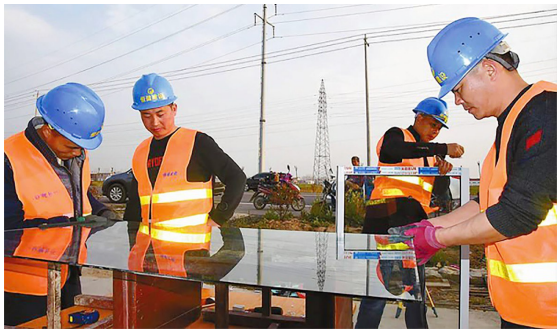
3月26日下午,修缮施工队工人们正在给因爆炸事故受损的陈港镇六港居委会居民蔡术金家制作门窗。 单丹摄
