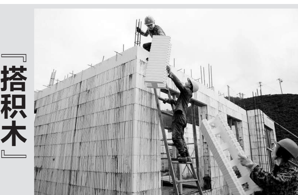
「搭积木」 通讯员齐振松、徐盛摄影报道 日前,在开化县池淮镇工业功能区区内,工人们徒手搬起建材,像搭积木一样建造房屋。这是浙江弘昇新型建材科技有限公司在此运用EPS模块新型节能建筑材料兴建的样板房。弘昇EPS模块今年3月已通过国家化学·建材质量监督检测中心检测,其强度是砖墙7.2
