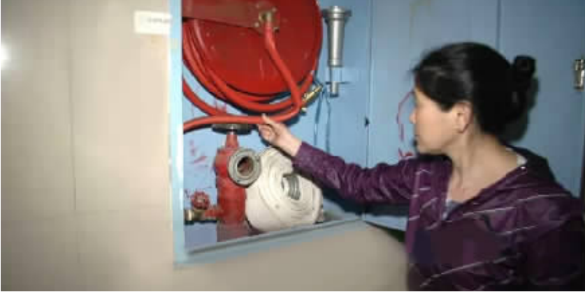
4月30日,桔园经典小区业主向记者展示该小区消防栓内状况,常年缺水,锈迹斑斑。 记者 张洋银 摄
