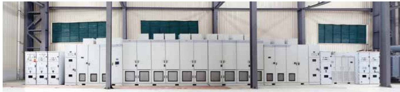
AS800-12000-T10-PAD 高压变频器 / 核电站水泵测试台应用案例
