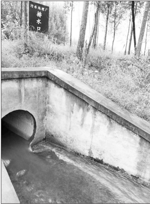
图为河南省开封市安河黑岗口水源保护区内的生活污水处理厂排放口。
