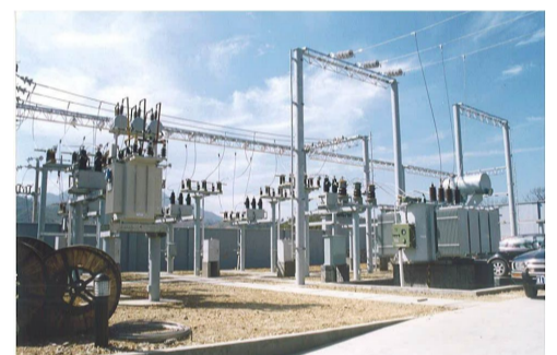
2007年,国网临安市供电公司将原有的35千伏龙岗变电站升级为110千伏变电站,为白牛村的腾飞插上电力翅膀。
