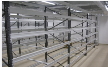
環控栽培室內的設施裝置
