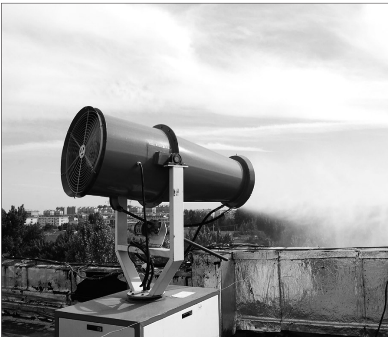
山东省平原县为有效治理扬尘污染，在城区行政事业单位大力推广固定或流动水炮等自动化洒水降尘设施。图为一家机关事业单位楼顶安装的固定水炮正在进行喷雾净化作业。
