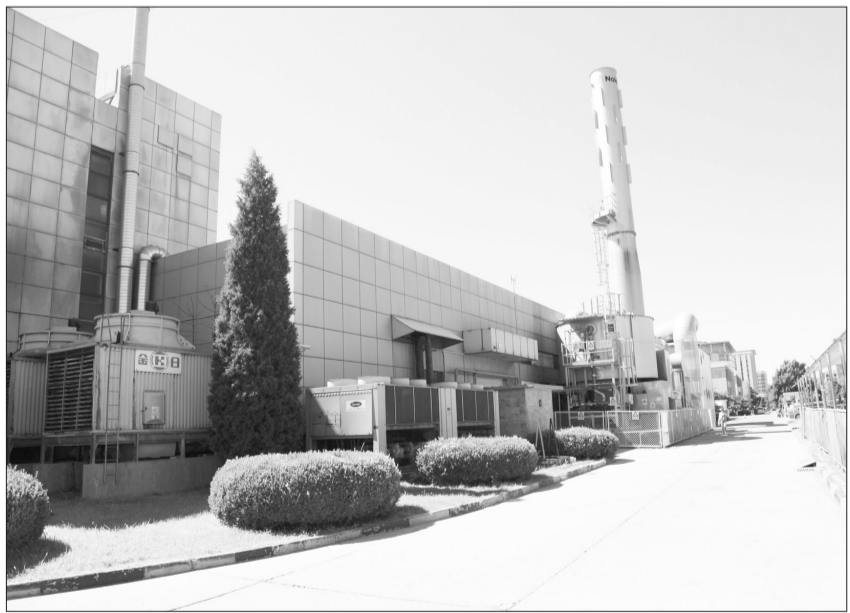
图为诺兰特公司喷涂生产线VOCs治理设备。
