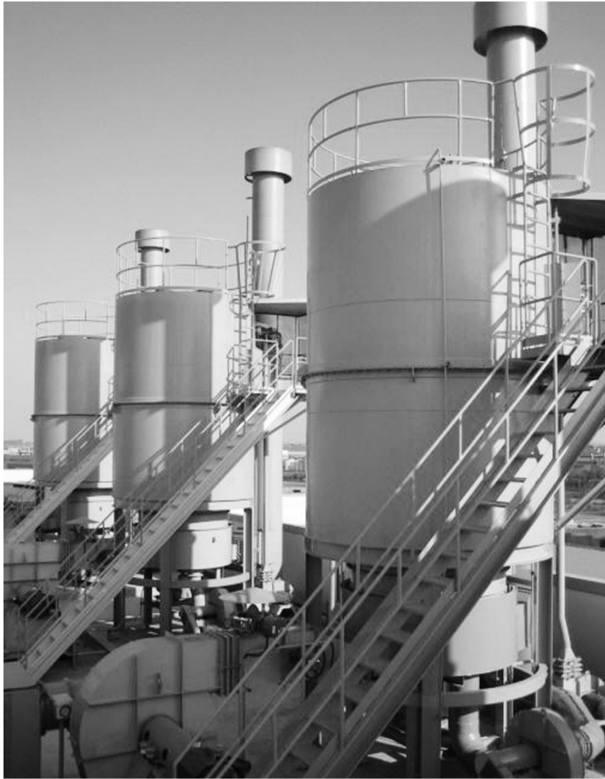
图为VOCs治理装置。
