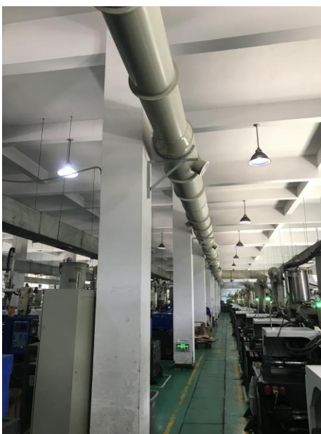
图 4-3 注塑车间集气管道照片
