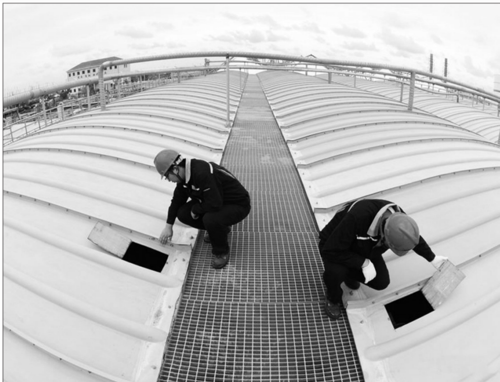
江苏省连云港市不断加大城区污水处理设施建设力度,今年全市计划投资5.2亿元,新增5万吨/日污水处理能力,扩建1万吨/日污水处理设施1座,新建管网150公里。图为技术人员8月28日在连云港市徐圩新区东港污水处理厂巡视设备运行情况。中国日报图片网供图
