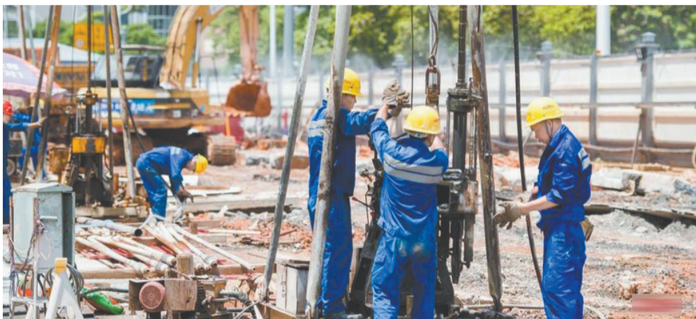
深圳地铁9号线支线施工稳步推进,目前正进行围护结构的施工。
