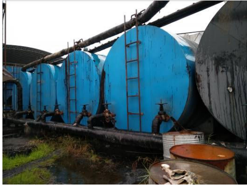
沥青罐（4个）及重油罐（1个）
