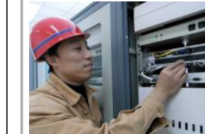
水电厂电讯车间肩负着河南分公司电话通讯网的保障任务, 3000 多个用户网点遍布分公司机关部室及各生产岗位。
