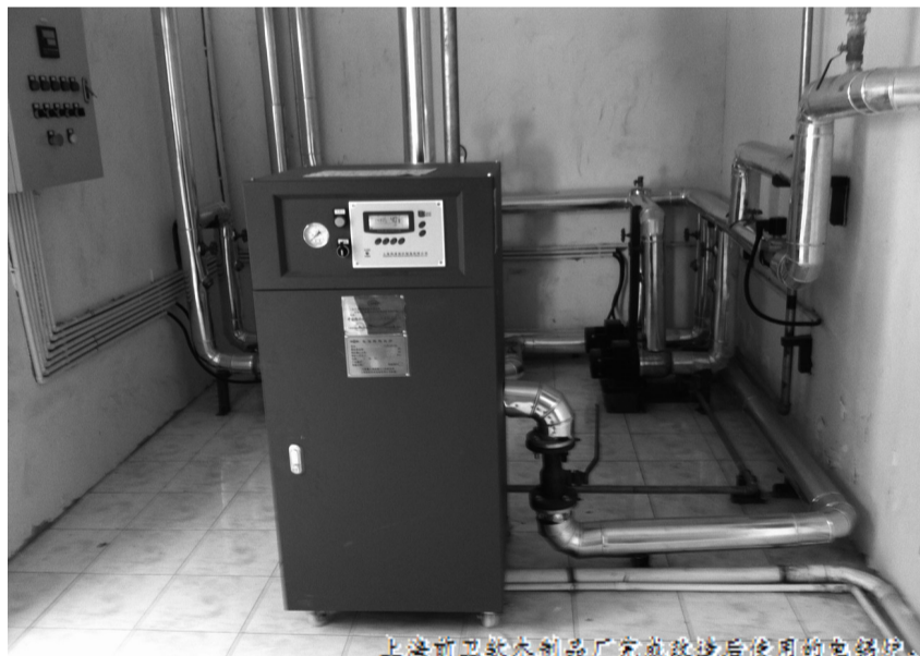
上海前卫软木制品厂完成改造后使用的电锅炉。
