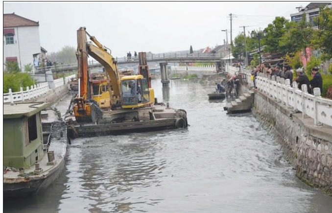
日前,沙沟镇投资90多万元,对镇区河道进行疏浚改造,预计6月中旬竣工。 任虹 姜洪义 摄
