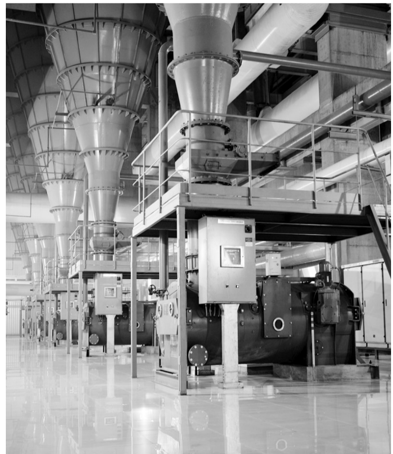
国华定州发电公司3号机组超低改造是国华电力首台600兆瓦等级燃煤机组“高品质绿色发电计划”项目。图为3号炉给煤机平台。
