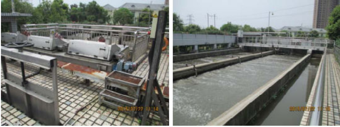
图 2-3 团洲污水处理厂细格栅和曝气沉砂池现状图
