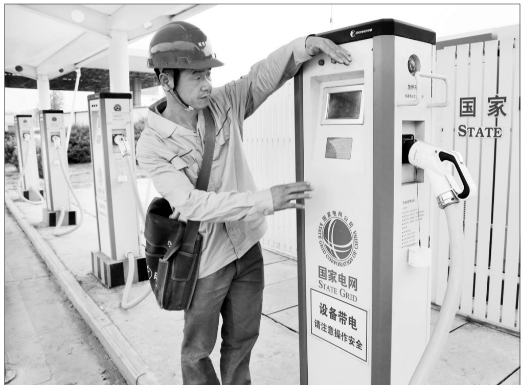
安徽省宿州供电公司加快推进电动汽车快速充电网络建设,在辖区内京台高速公路两个服务区已建成4座充电站的基础上,今年将在辖区内高速公路4个服务区新建8座充电站32个快速充电桩,方便市民采用低碳环保生活方式绿色出行。 人民图片网供图
