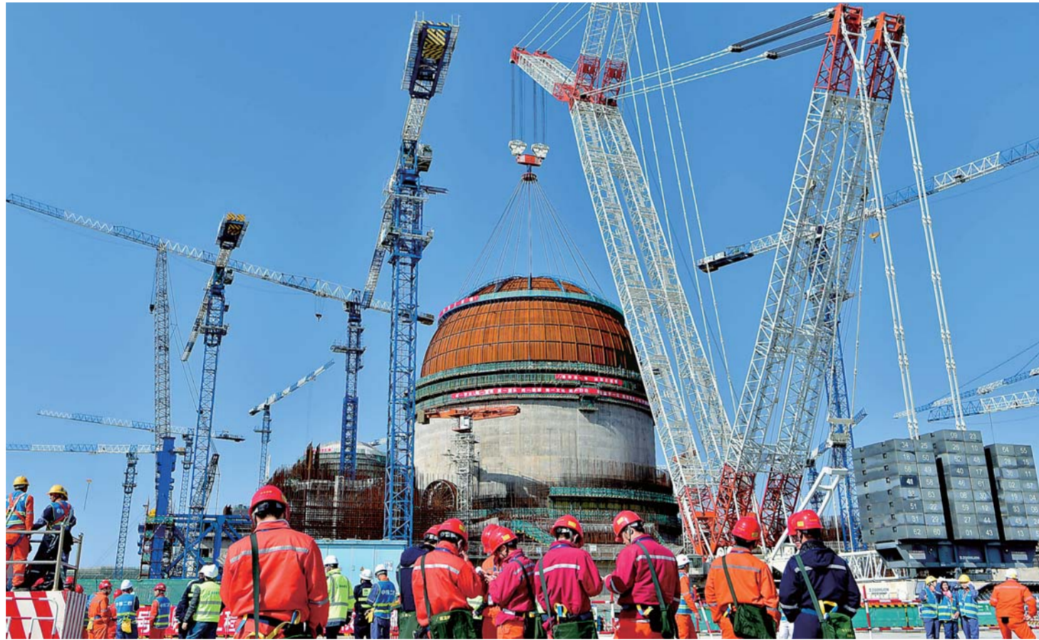
▲2018年3月21日，中核集团福清核电6号机组反应堆穹顶吊装成功。此次穹顶吊装标志着国内第二台“华龙一号”机组建设将由土建工程全面转入设备安装为主的施工阶段，表明我国自主三代核电技术工程建设正在稳步有序推进。
