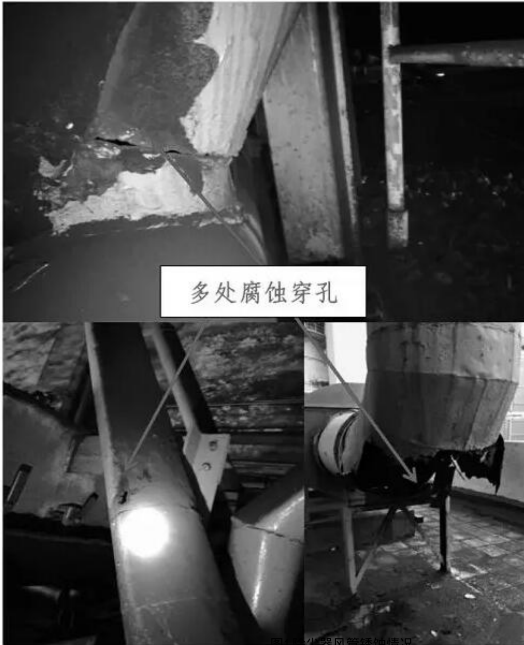
图1 除尘器风管锈蚀情况
