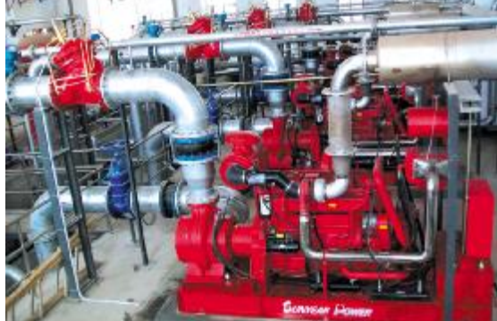
东方航空昆明新机场基地项目机务工作区动力中心消防工程采用三业科技研制生产的“数字定压柴油消防泵”。
