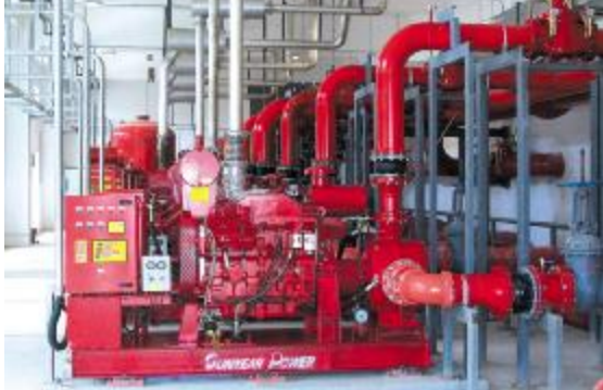
三业科技为上海波音6号泵房提供了7台数字定压柴油水泵及恒扬程/止回阀。
