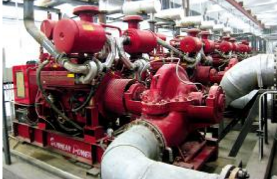
三业科技研发的“智能柴油消防水泵”产品在首都机场A380机库工程中应用。
