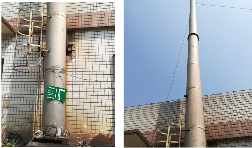
图4 废气排污口（锅炉排气筒）照片图
