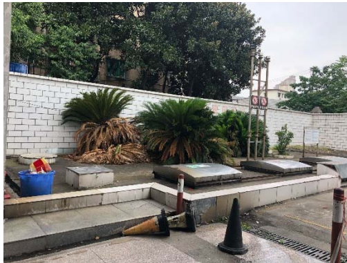
图 6-1 油罐区废气有组织排放立管
