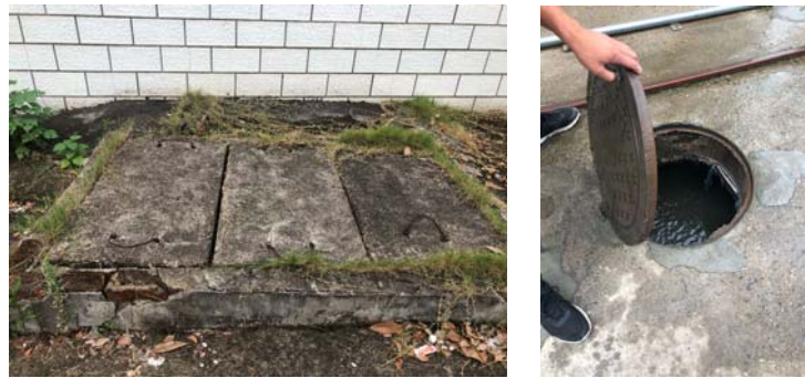
图 3-5 化粪池和隔油池
