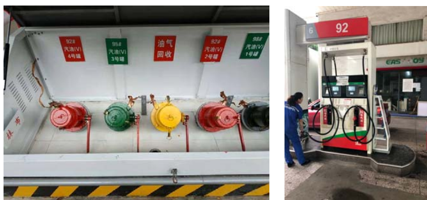
图 3-3 卸油区一次回收系统和加油机二次油气回收系统
