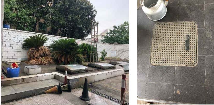
图 3-7 油罐区防渗池及监测井
