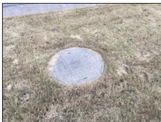
图 6-6 变电站内雨水井
