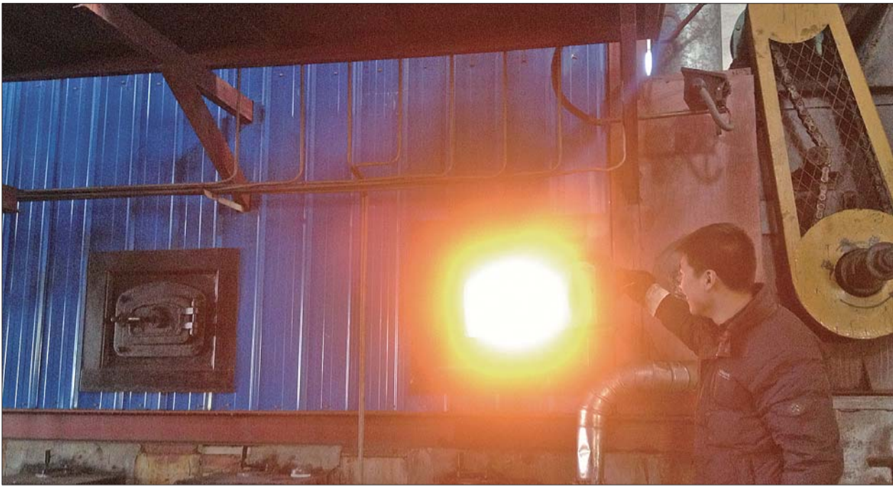
工作人员正对锅炉进行检查。 见习记者 张飒特 摄
