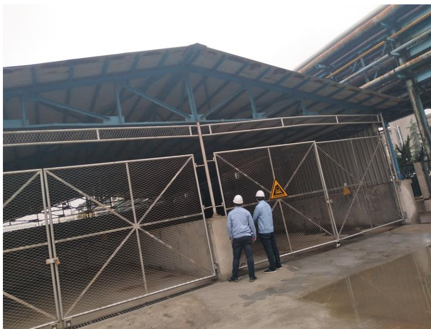
图 3 现有炼油厂危废库现状图
