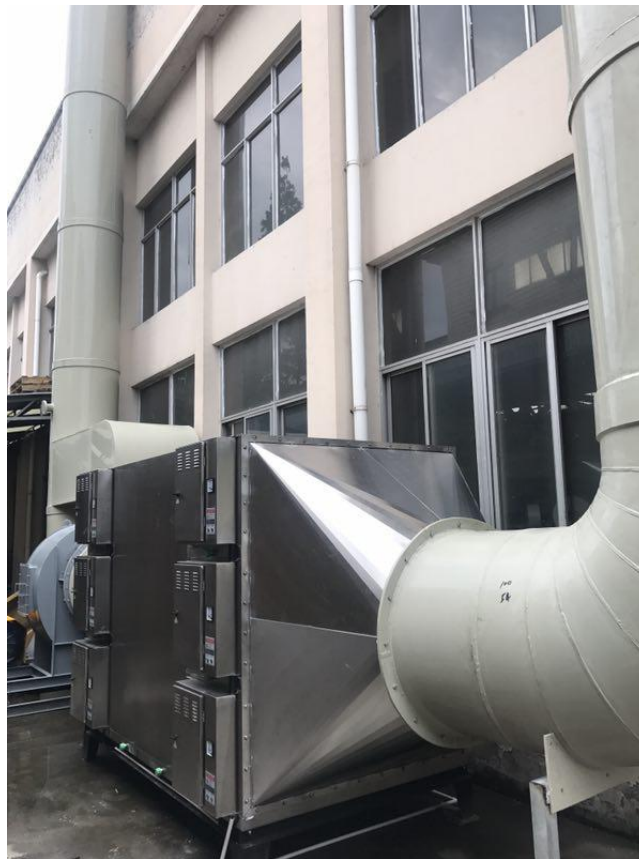
废气处理设施（静电除油）
