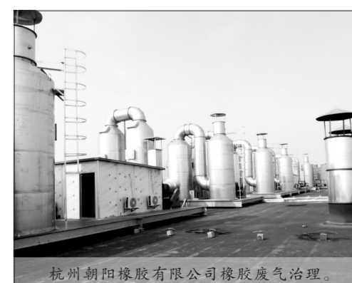
▲杭州朝阳橡胶有限公司橡胶废气治理。
