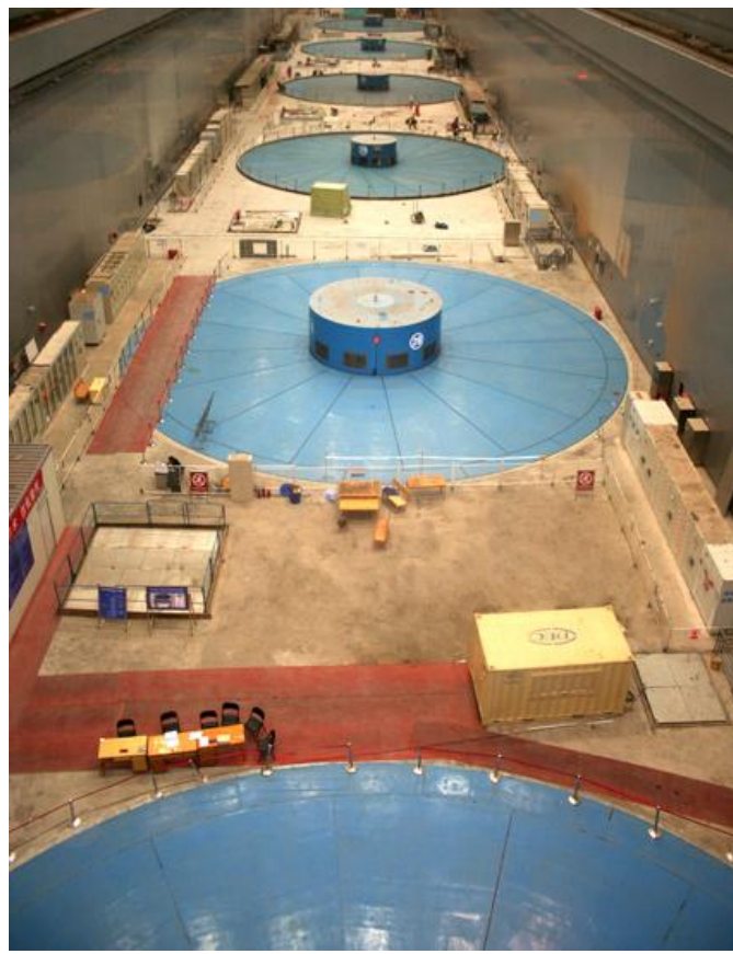
90年代,葛洲坝承担了三峡工程18台70万千瓦水轮机组安装调试任务
