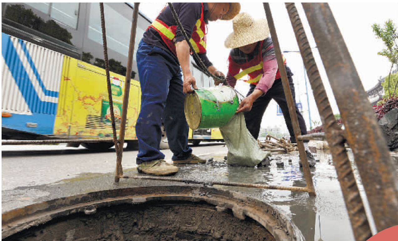
4月14日,长沙市湘江中路西湖桥段,施工人员将4米多深下水井里的水泥块清理出来。该路段附近一工地近几日施工时,不慎将水泥块及杂物落入下水井中,导致管网堵塞。 记者 田超 摄
